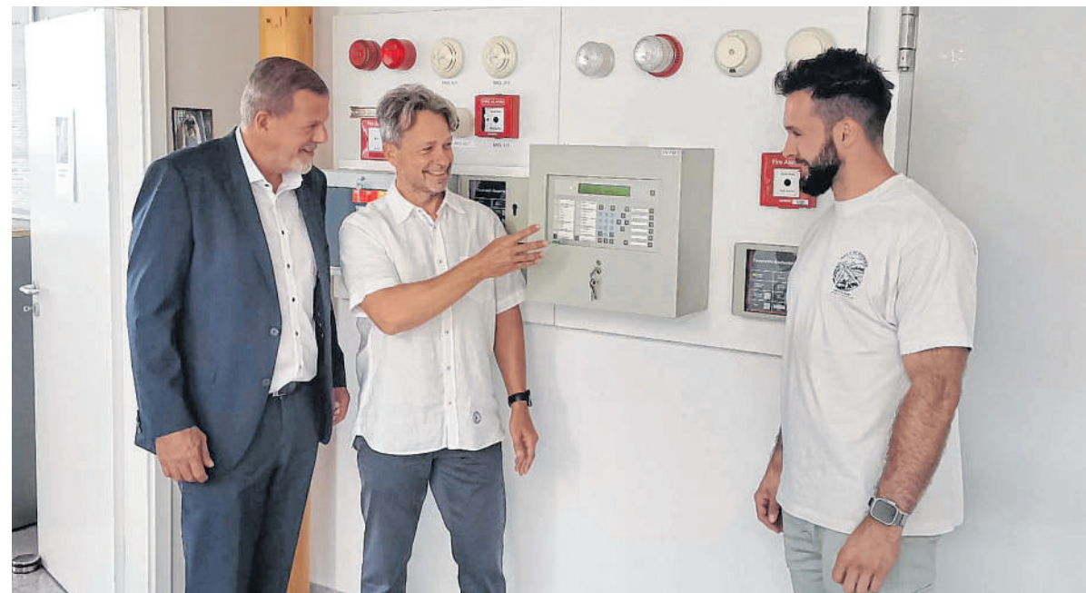
Oberbürgermeister Marcus Zeitler (links) lässt sich von Firmengründer Rüdiger Wörner (Mitte) und dessen Sohn Tobias die Brandmeldetechnik erläutern, die das Unternehmen für Kunden spezialisiert. BILD: MÜLLER
